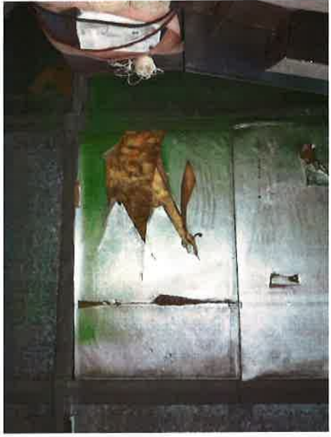
Bâtiment 1 : Plaquas murales susceptibles de contenir de l'amiante
