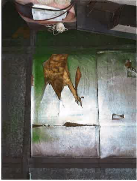
Bâtiment 1 : Plaques murales susceptibles de contenir de l'amiante
